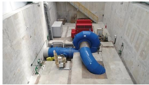
水力発電設備（5.00MW×2）
